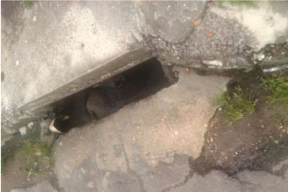
Figura 07. Bueiro a céu aberto com presença de lixo no seu interior.
