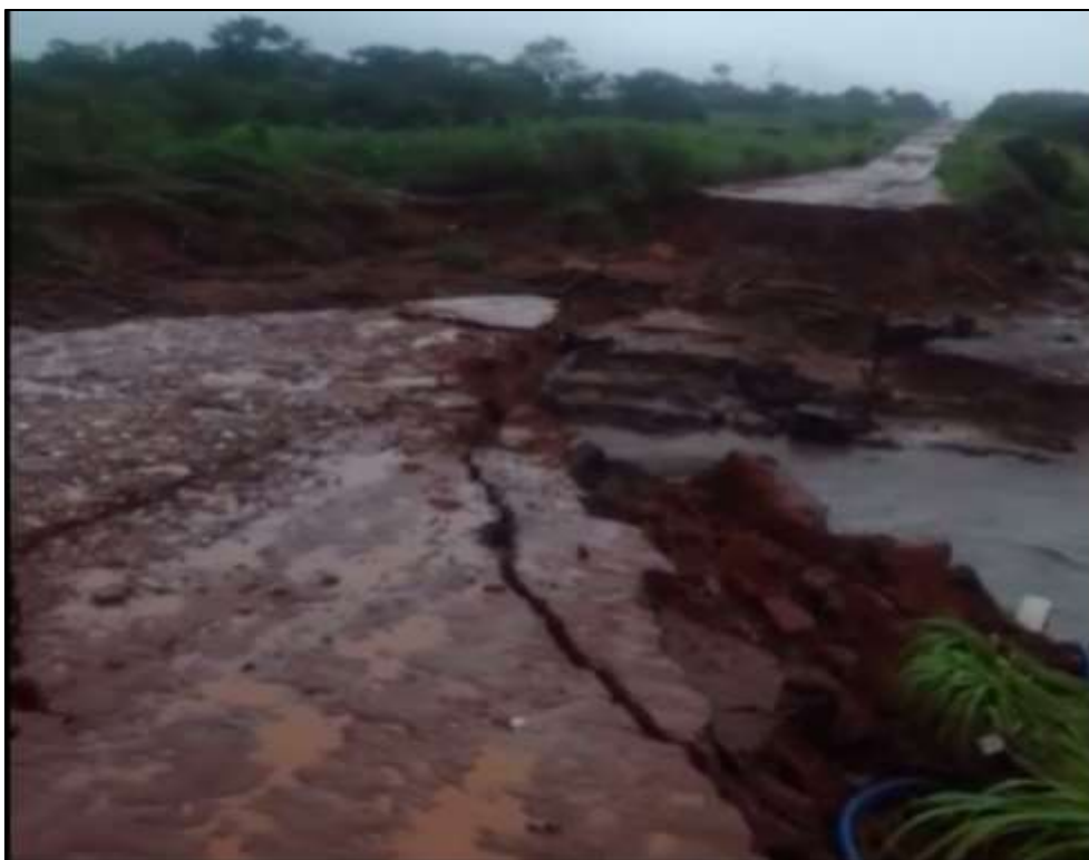
Figura 6 - Danos na estrada do bairro do Saltinho pelo rompimento de represa
