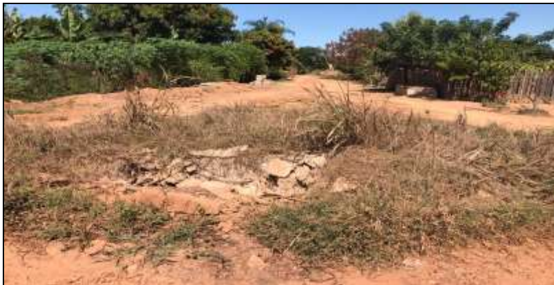
Figura 7 - Rede de esgoto não finalizada.
