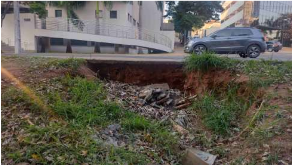
Figura 4: Erosão no Parque do Povo
