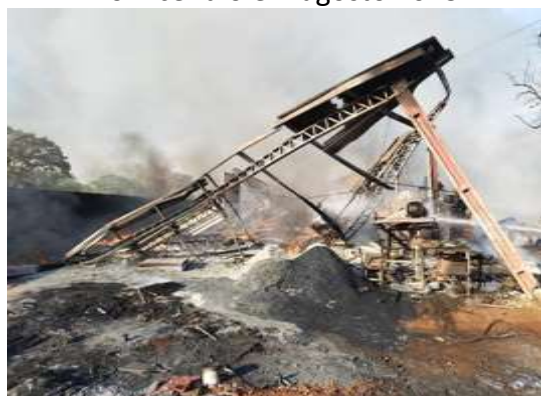
Figura 8 – Porto Nacional: estrutura metálica do galpão da ACCS-PN destruída no incêndio em agosto 2023
