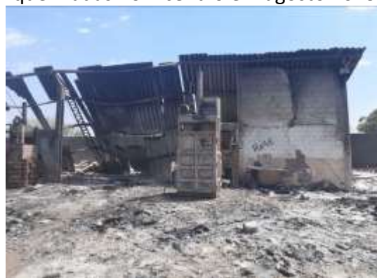
Figura 9 – Porto Nacional: estruturas do galpão e da prensa da ACCS-PN queimadas no incêndio em agosto 2023
