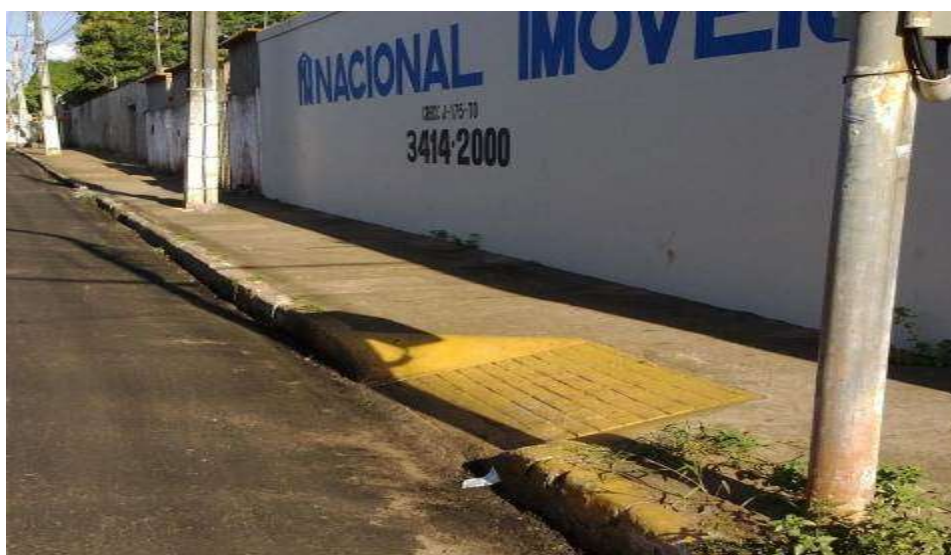
Foto 03: Calçada irregular II
