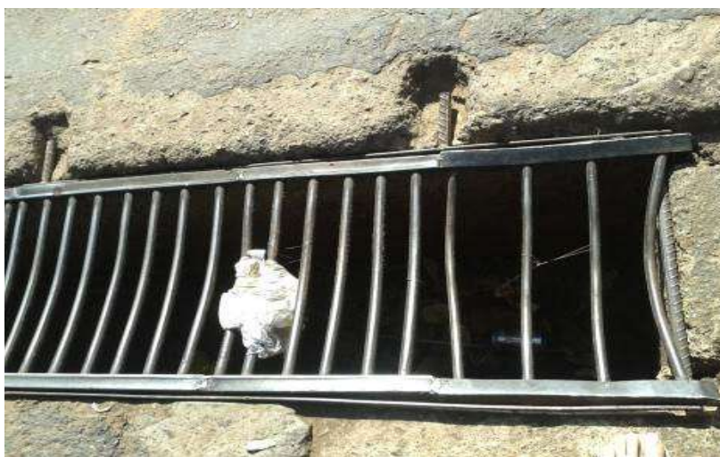
Foto 01 – Grelha de água pluvial
