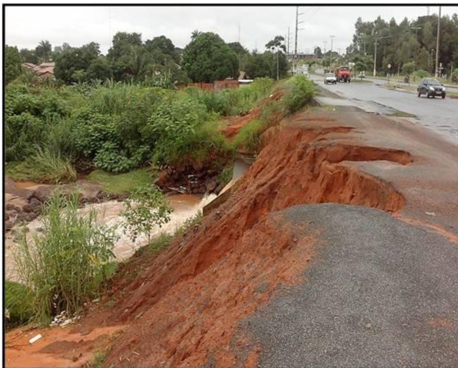
Figura 3. Trecho da Avenida Filadélfia às margens do Córrego Neblina apresentando erosões
