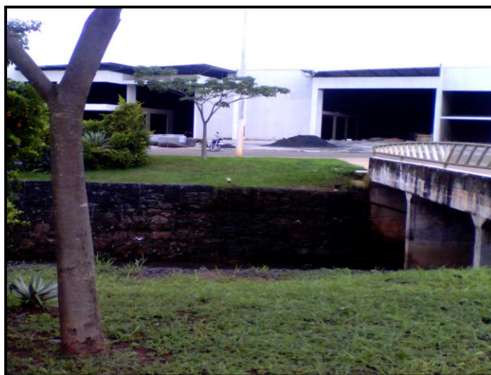
Figura 5. Prédios comerciais em construção às margens do Córrego Neblina Fonte: BARROS, Eudarcia Silva. 10/03/2014.
