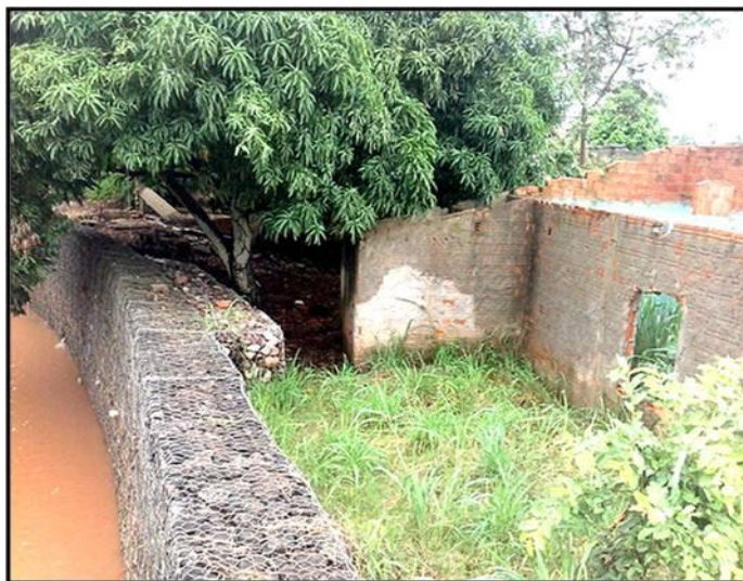
Figura 4. Trechos as margens do córrego neblina com construções irregulares Fonte: BRITO, A. M. 16/02/2014
